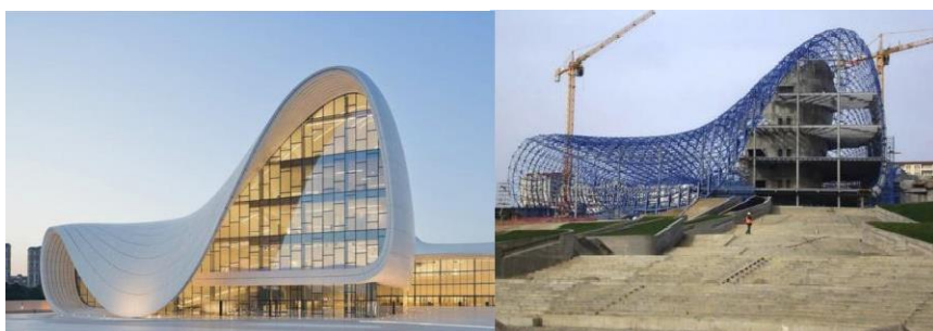
شكل (20) آلية التقسيم للأسطح من الآليات البارامتريّة القوية التي ساعدت على سهولة تنفيذ الخطوط المنحنية بشكل دقيق جداً في مبنى حيدر حليف الثقافي من أعمال المعمارية زها حديد 2
